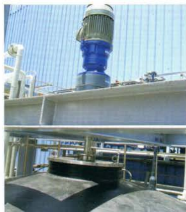
化工儲槽（格南軸封）
